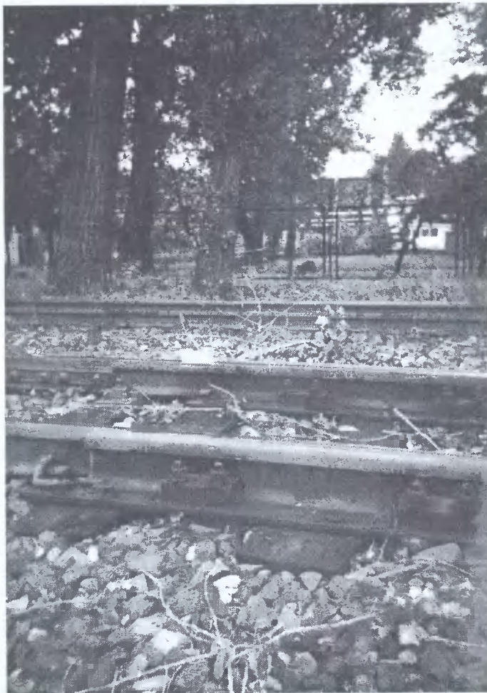
Rys.4. Lokalizacja oderwanej liny względem miejsca awarii rurociągu żeliwnego \varnothing 80 mm
