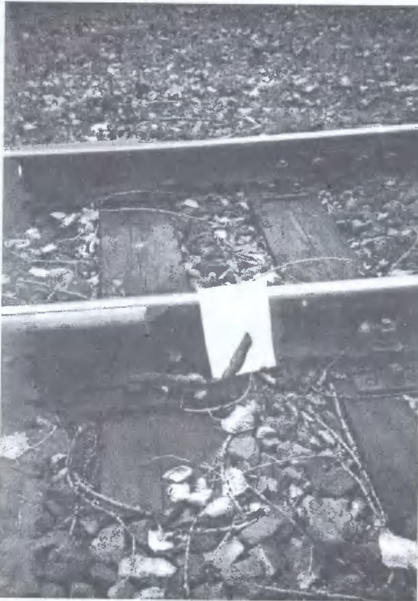
Rys.3. Oderwana lina łącząca iglice szyn na kompensatorze ruchów termicznych
