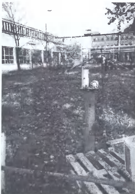
Rys.6. Widok na nadziemną część piezometru z zainstalowanym limnigrafem
