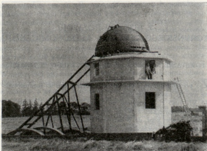
5. Budowa pierwszego pawilonu obserwacyjnego w 1948 r.: 5-metrowa kopuła zbudowana w Toruniu, w całości przetransportowana do Piwnic i bez pomocy dźwigu zamontowana na wierzchołku budynku
