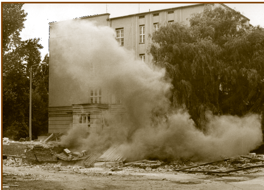
Bydgoszcz, saperzy wyburzają murowany barak, w miejscu którego powstanie budynek „starej patomorfologii”, 1 wrzesień 1975.
