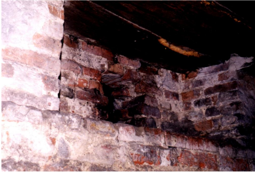
Fragment krenelaża, widoczny w kamienicy przy ul. Szkolnej 1, poniżej poziomu ul. Szkolnej.
