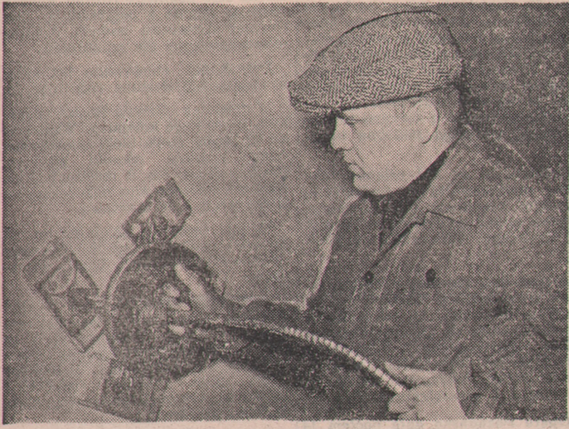
Na terenie budowy osiedla Koto w Warszawie został przeprowadzony pokaz zacierania tynków mechaniczną zacieraczką konstrukcji znanego racjonalizatora Michała Krajewskiego. Przy zastosowaniu mechanicznej zacieraczki możliwe jest zacieranie od 60 do 80 m 2 dziennie. Na zdjęciu: Instruktor Ministerstwa Budownictwa Przemysłowego Karol Obrok, demonstrowa pracę mechanicznej zacieraczki. (CAF) — fot. Kondracki
