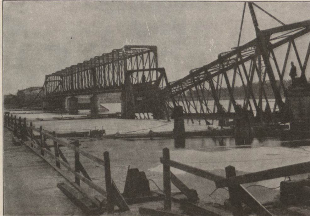
Sapostitais dselsszeļa tilts pee Buldureem. Le pont de fer ruiné de Bulduri. Damaged railway bridge in Bilderlingshof.
