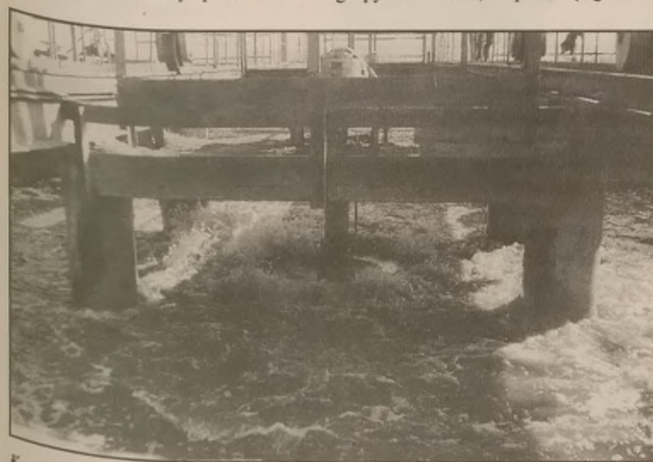
Komora wstępnego napowietrzania, gdzie następuje napowietrzanie oraz uśrednienie ścieków. Na środku widać pracującą turbinę. fot. Paweł Dobies
