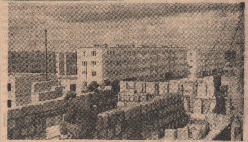
Budowa osiedla mieszkaniowego „Kolo" w Warszawie postępuje szybko naprzód. Na zdjęciu: Brygada Mieczystwa w Szymańskiego zatrudniona przy budowie bloku VIII wyrabia przeciętnie 180 proc. normy. (Foto — CAF)
