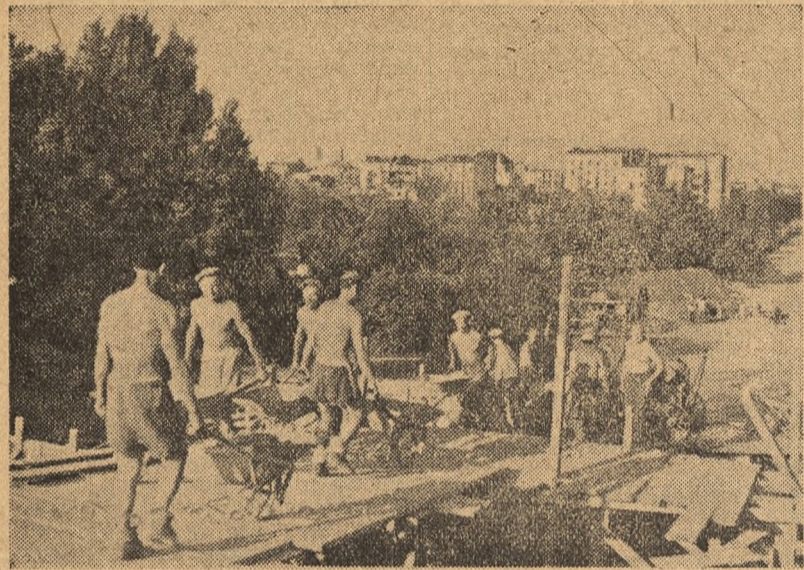
Prace przy budowie Centralnego Parku Kultury na Powiślu w Warszawie posuwają się szybko naprzód. Przy budowie pomagają również ochotnicze grupy robotników i pracowników umysłowych z warszawskich zakładów pracy oraz młodzież zetemowska.
