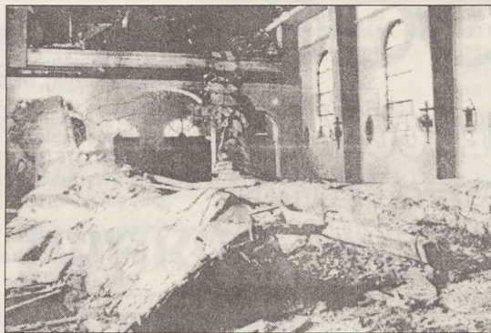
Wnętrze kościoła po zawaleniu się stropu.
