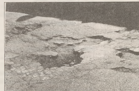
Dziury w jezdni na ul. Lewandowskiego
