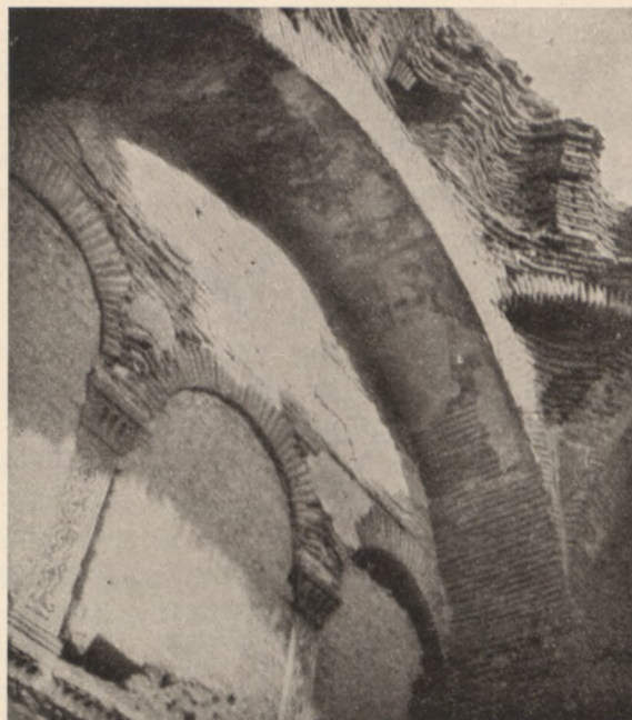
Abb. 340. Klemenskirche in Ankyra, Bogenstellung der Empore und Ecknische (bzw. Zwickel) (nach O. Wulff, Die Koimesiskirche in Nicäa 1903).
