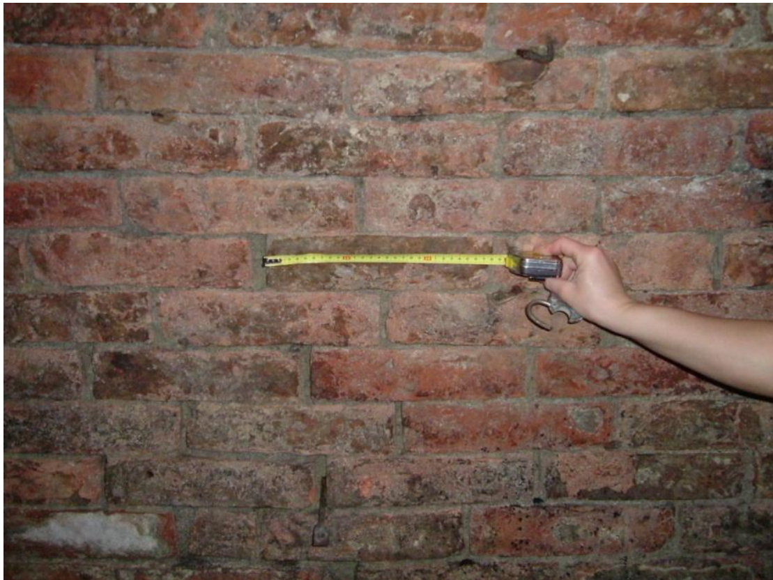
2. ul. Kościelna 31. Ściana w piwnicy.
