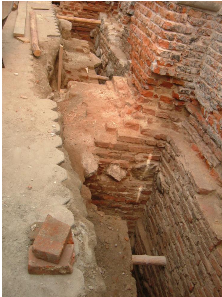
6. Ściana południowa kościoła pojezuickiego. Stan w 2006 r. Wiązanie wozówkowe, z użyciem cegieł romańskich. Wykop wykonany w celu wykonania izolacji fundamentów. Mur został zasmolowany.
