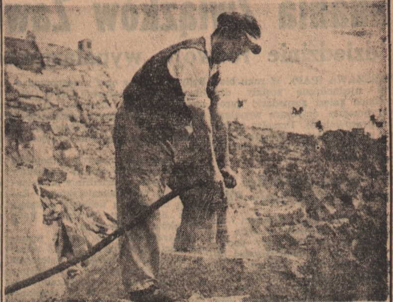
Dla uczczenia 34 rocznicy Wielkiej Socjalistycznej Rewolucji Październikowej, Strzebińskie Kamieniołomy Drogowe dadzą w miesiącu październiku 150 wagonów kostki i krążników granitowych więcej niż we wrześniu. Na zdjęciu: skalnik, Stanisław Skrzypczak uzyskujący 250 proc. normy. (Foto — CAF)
