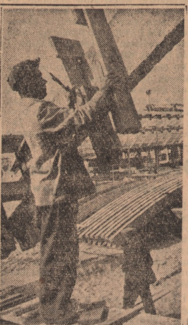
W Zielonce k/Warszawy powstaje cegielnia „Gigan”. Na zdjęciu: Tadeusz Kilak z brzoławy Bąszka, która osiąga 220 proc. normy, przy montażu konstrukcji betonowych dachu hall produkcyjnej.
