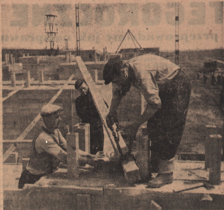
W szybkim tempie powstaje jedna z wielkich budowli Planu 6-letniego — Cementownia Wierzbice. Na zdjęciu: Brygada ciesielska w składzie Czesław Stobryn, Franciszek Nowak i Aleksander Dzik przy wyciąganiu tzn. karków z fundamentów pieca.
