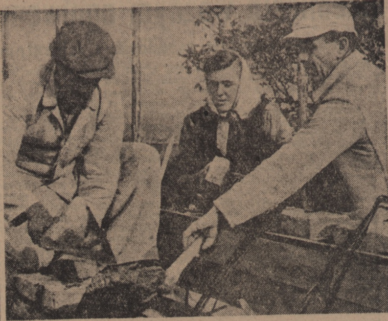
Przy budowie nowej szkoły w Karow-Buch pod Zwickau w Saksonii zastosowano w NRD po raz pierwszy — według wzorów zaczerpniętych z Polski system trójkowy. Powyżej brygada murarska aktywistów Wolffa przy pracy.
