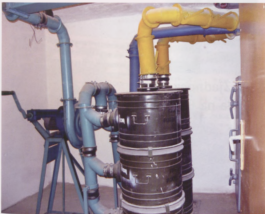
Urządzenie komory filtrowentylacyjnej
