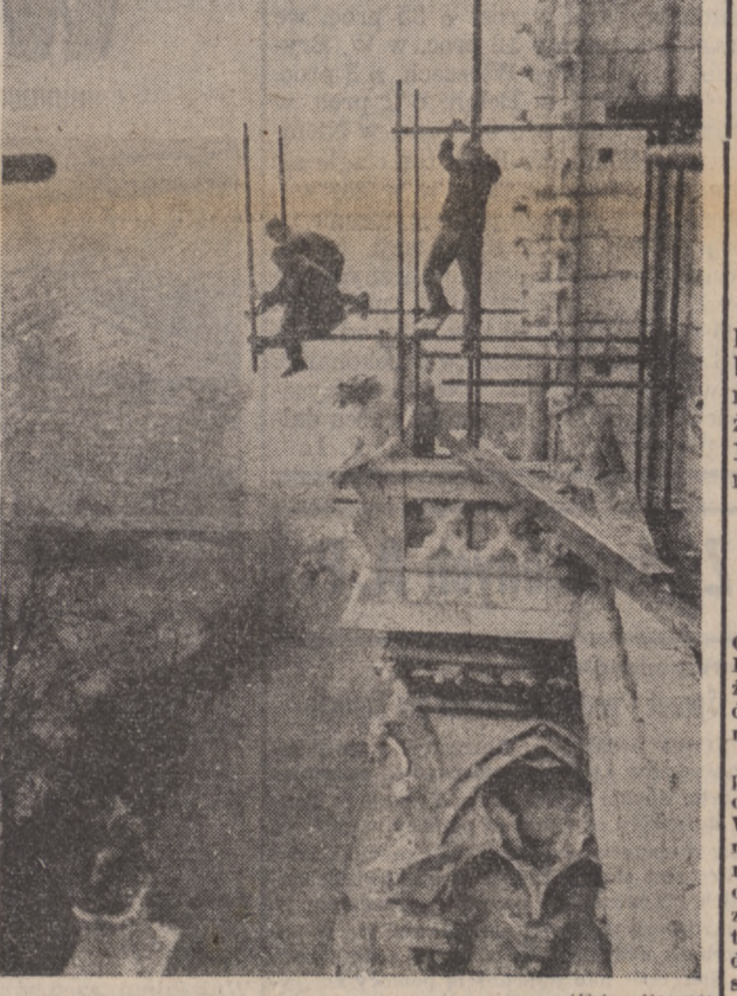
Specjaliści, którzy wnoszą rusztowanie wokół wieży katedry Notre-Dame w Paryżu, pracują na wysokości 60 m, wykonują swoją pracę spokojnie, nie ulegając zawrotowi głowy.
