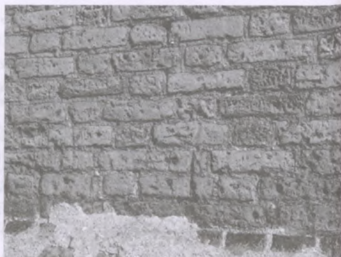
Nieckowate zagłębienia na elewacji bazyliki mniejszej w Chojnicach (Fot. M. Kołyszko).
