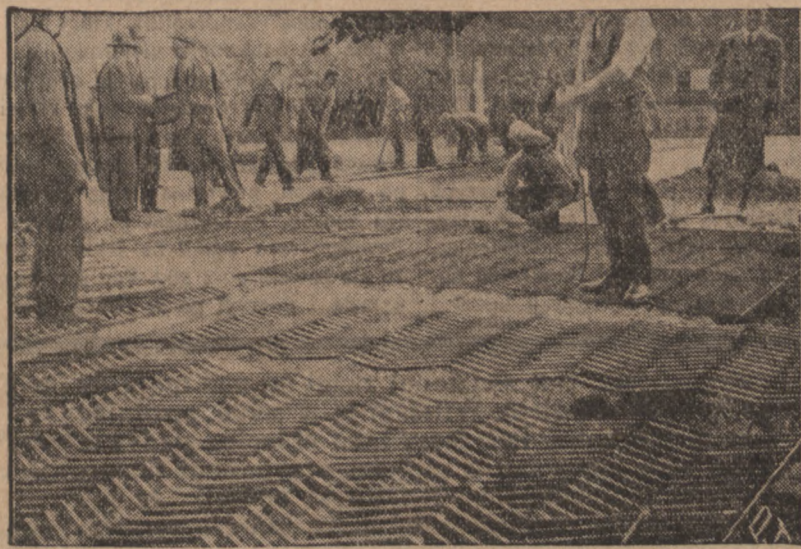
Na odcinku komunikacyjnym Katowice—Królewska Huta rozpoczęto budowę pierwszej na ziemiach polskich drogi stalowej. — Zdjęcie nasze przedstawia roboty przy budowie tej drogi. Na pierwszym planie widać rozpoczętą na ziemi siłą siatkę stalową.
