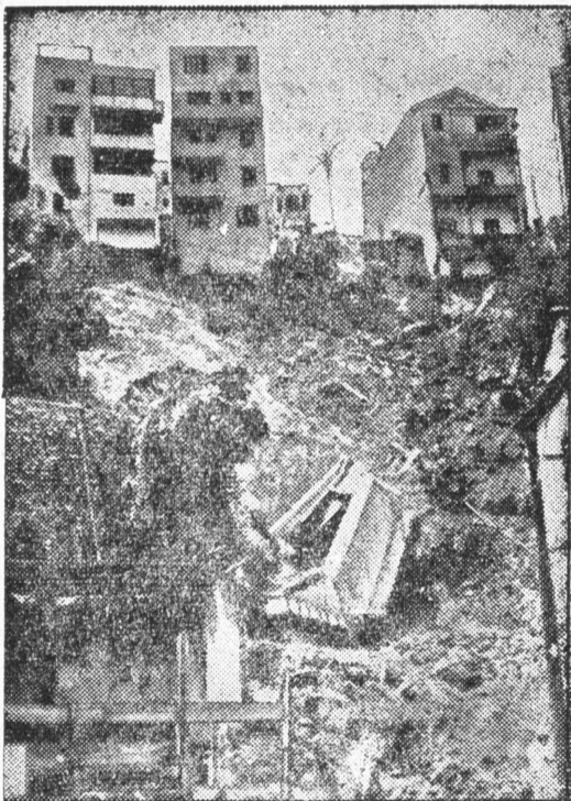
Cały dom runął ze zbroca w Rio de Janeiro po ulewnych deszczach, które podmyły fundamenty.
