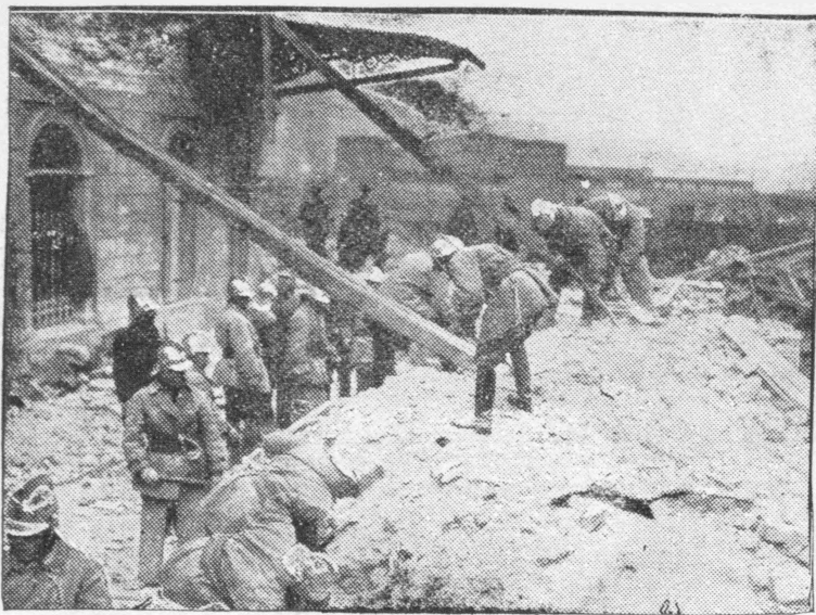
W ub. tygodniu wydarzyła się w Warszawie przy dworcu katastrofa budowlana, której ofiarą padło kilku robotników. Na zdjęciu widzimy straż pożarną zajętą usuwaniem gruzu.
