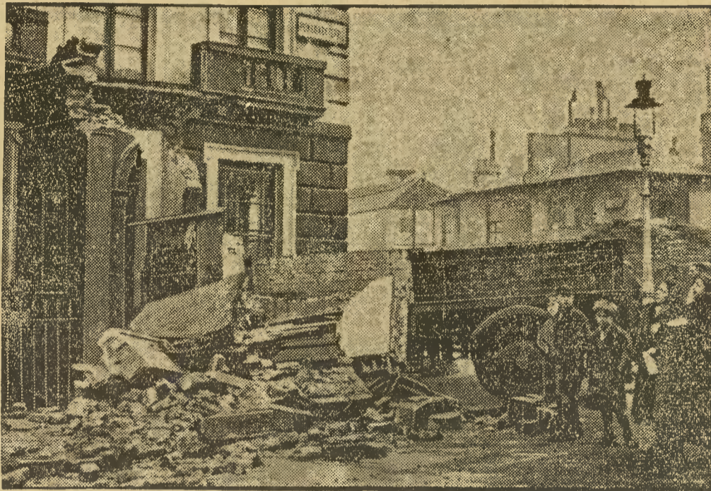
W Londynie zdarzył się niezwykły wypadek odczepienia się platformy od samochodu prowadzącego. Przyczepka wjechała na dom, burząc część muru, co spowodowało zawalenie się balkonu i zupełne zablokowanie wejścia do domu.
