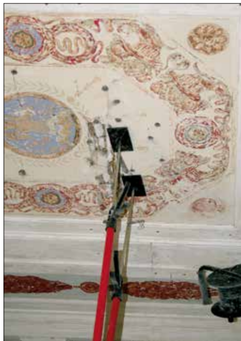
Fot. XV.13. Pałac Biskupi we Wrocławku. Jadalnia w trakcie prac konserwatorsko-restauratorskich. Podklejanie pęcherzy i rozspojen tynku.
