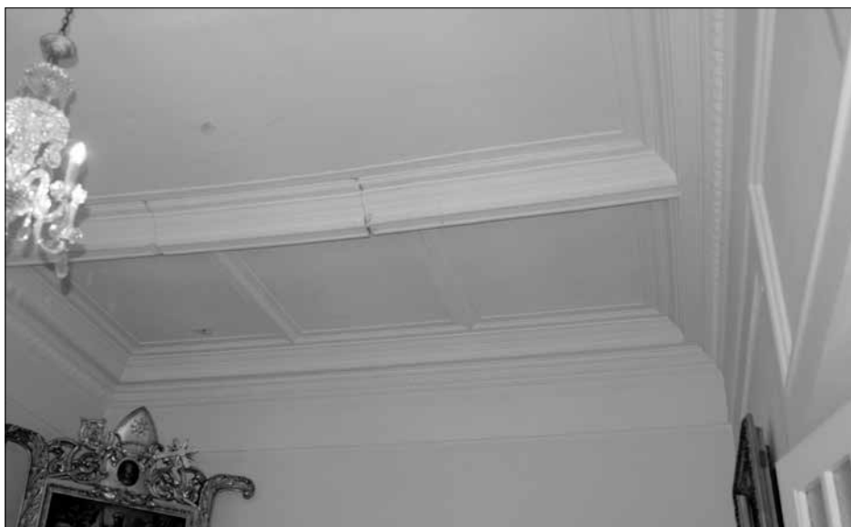
Fot. XV.1. Pałac Biskupi we Wrocławku. Kaplica przed pracami konserwatorsko-restauratorskimi. Widoczne zniszczenia wynikające z błędów budowlanych.
