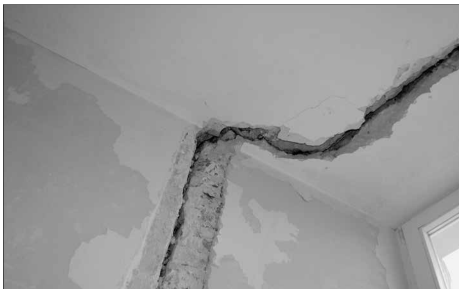
Fot. XV.2. Pałac Biskupi we Włocławku. Salon przed pracami konserwatorsko-restauratorskimi. Naprawy murarskie – naprawa więźań ścian i stropów.
