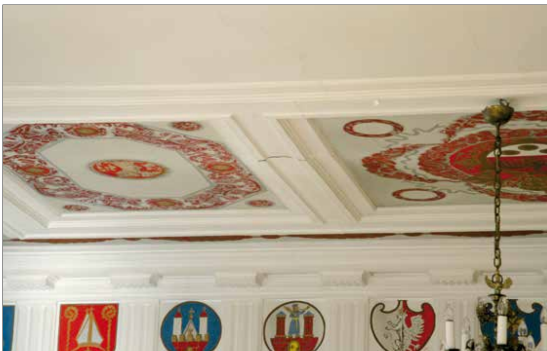
Fot. XV.12. Pałac Biskupi we Włocławku. Jadalnia przed pracami konserwatorsko-restauratorskimi. Widoczne uszkodzenia tynków na stropie spowodowane błędami budowlanymi
