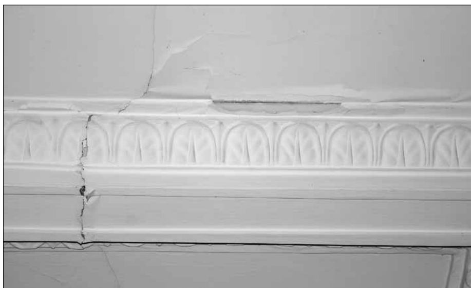
Fot. XV.3. Pałac Biskupi we Włocławku. Biuro Biskupa Ordynariusza przed pracami konserwatorsko-restauratorskimi. Sztukaterie pokryte grubą warstwą przemalowań utraciły swoją tektonikę. Zniszczenia mechaniczne spowodowane błędami budowlanymi.
