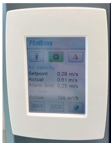
Rys. 3. Panel obsługujący dygestorium firmy Halton
